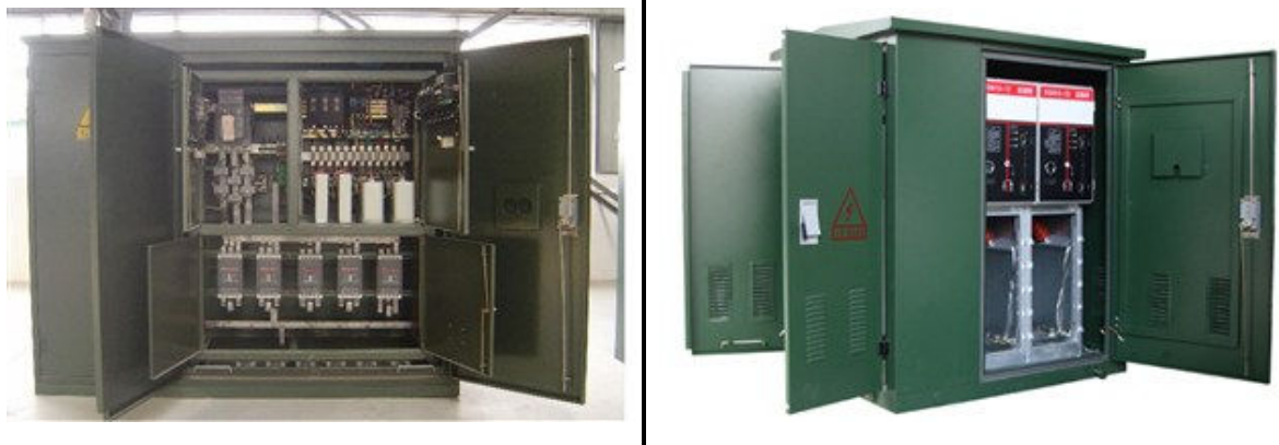
图 2-1 开闭所机柜样式照片
