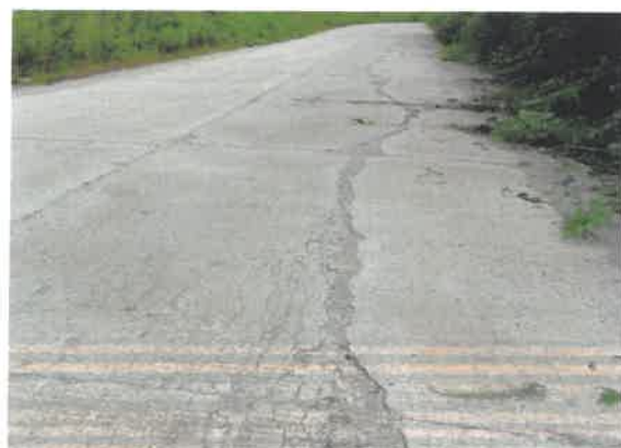
道路裂损情况
