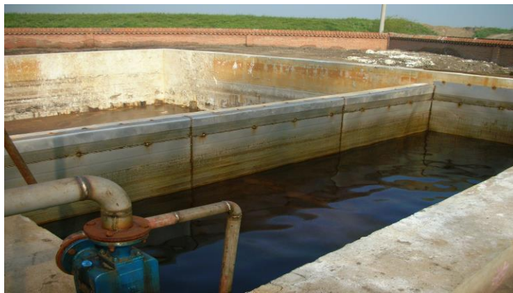
图 5-7 工艺废水收集池
